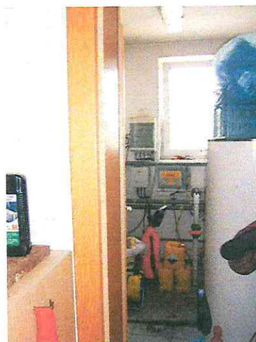
Plynová kotelna za garáží
