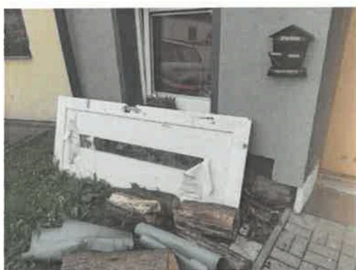
Původní (poškozené) vstupní dveře
